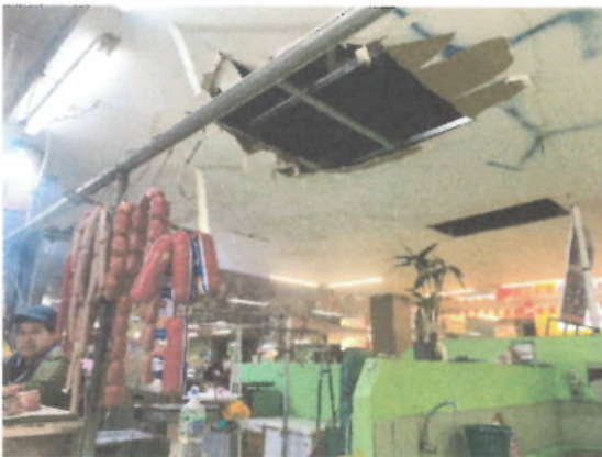
Imagen 7. Techos descubiertos y destruidos.
