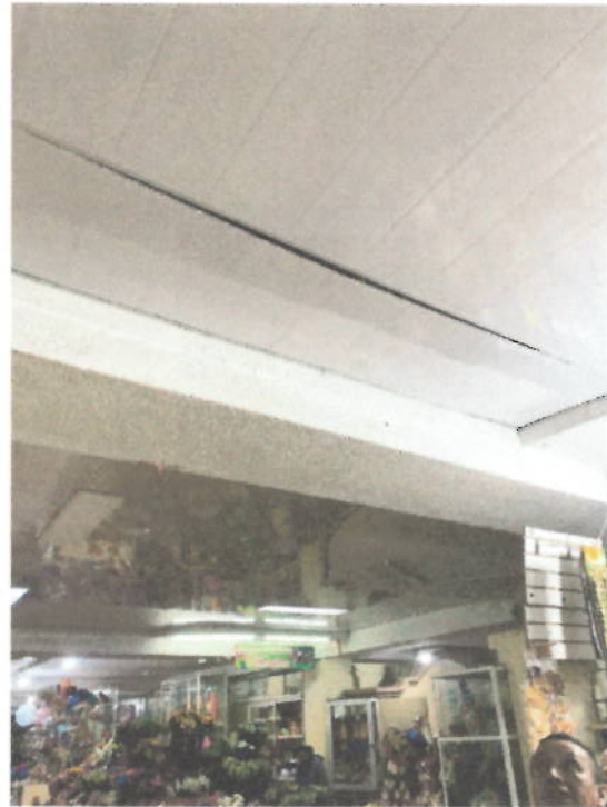
Imagen 6. Aberturas en el techo.
